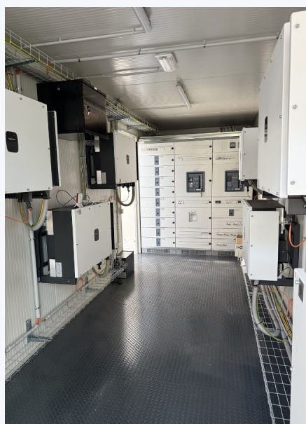
Locale BT Inverter su entrambe le pareti
