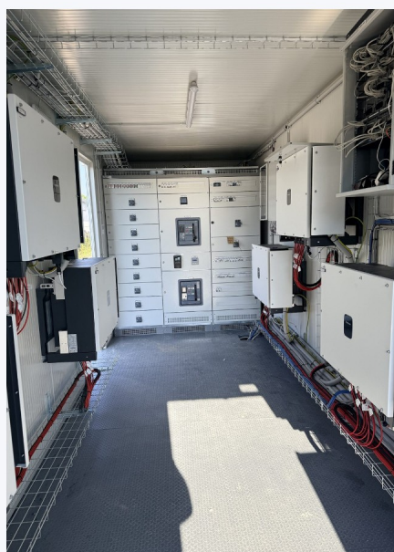
Cablaggi Passerelle a filo, cavi identificati
